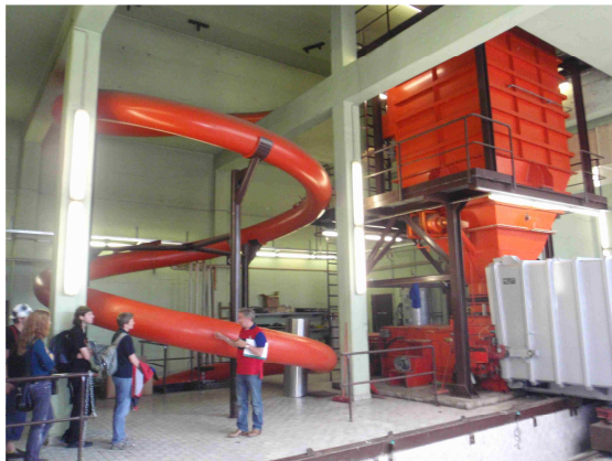
Zentrale Sammelstelle mit der Abfallabwurfsschächte der Wohnhausanlage in Alt Erlaa.
