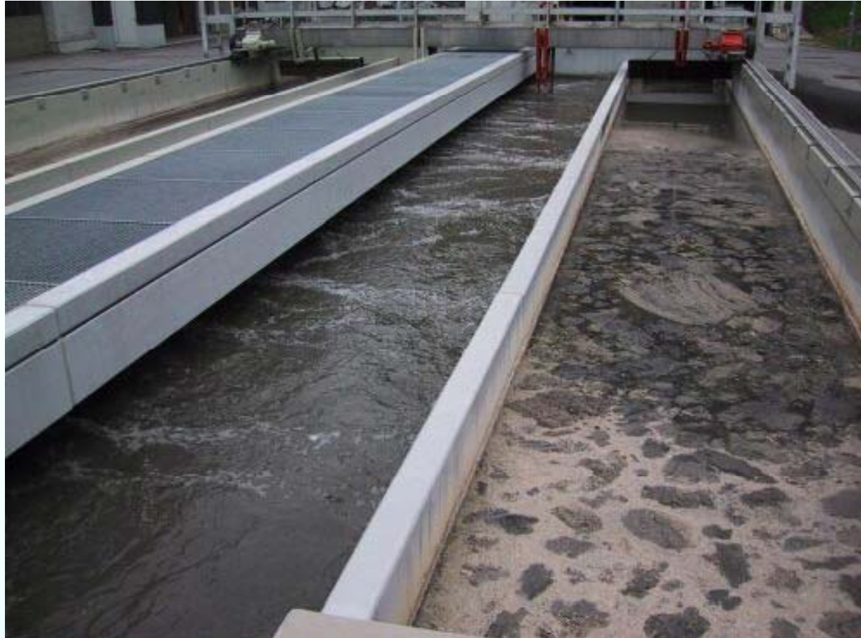
Longitudinal grit chamber
