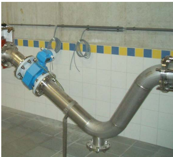
Abb. 2: MID-Messstrecke mit Düker ( http://de.wikipedia.org )
